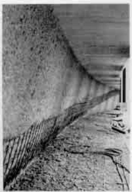
Fig. 44. Web spalling (courtesy of Clarence R. Yamamoto).
